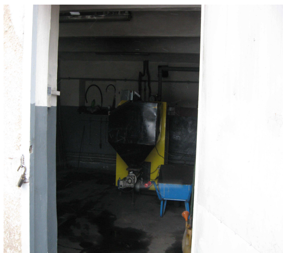
Widok na kotłownię
