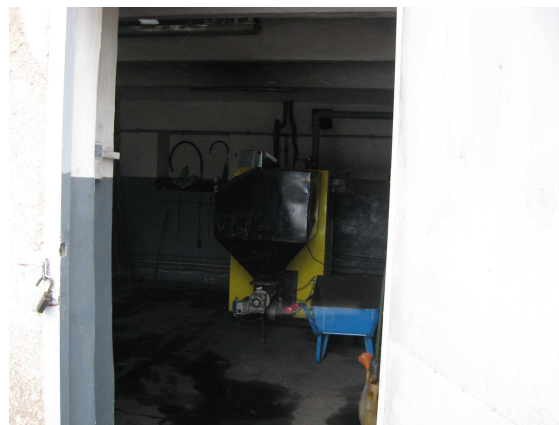
Widok na kotłownię
