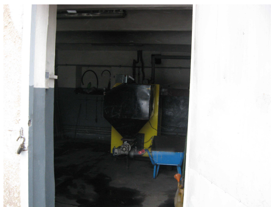
Widok na kotłownię
